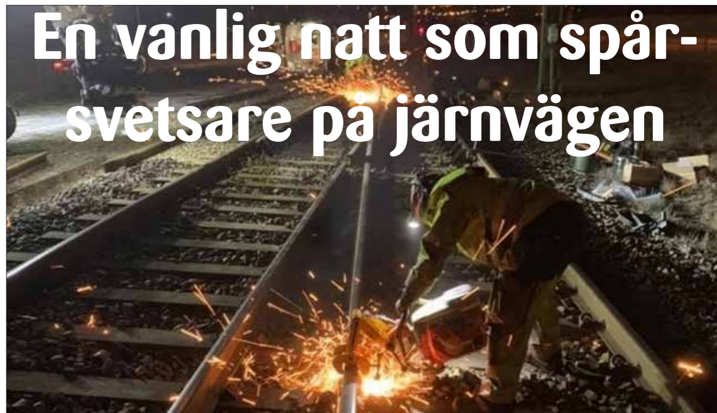
Inkapning av passräler efter det att den gamla korsningen kapats bort och den nya lagts in på rätt plats. Kapningen utförs av Magnus Björkman från MP Spårservice och Björn Hagberg från NRC Group.
