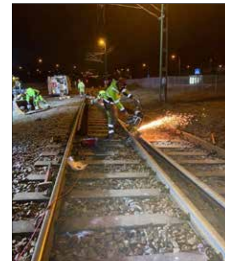
Slipning av termitsvetsen samt städning av arbetsplats. Peter Andersson från MP Spårservice samt Dennis Järgren och Björn Hagberg från NRC Group och Leif Andersson från Leifs maskinentreprenad.
